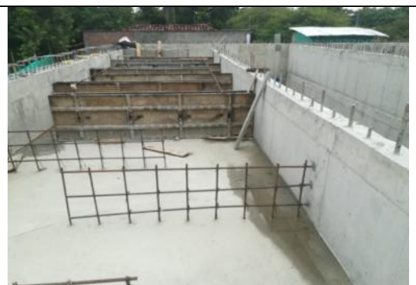
Tanque de almacenamiento y cloración
