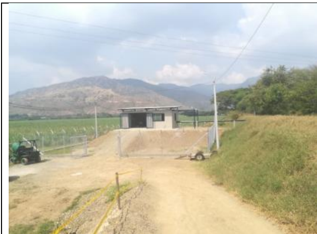
Pozo profundo – Caseta de bombeo
