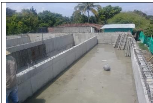
Tanque de almacenamiento y cloración
